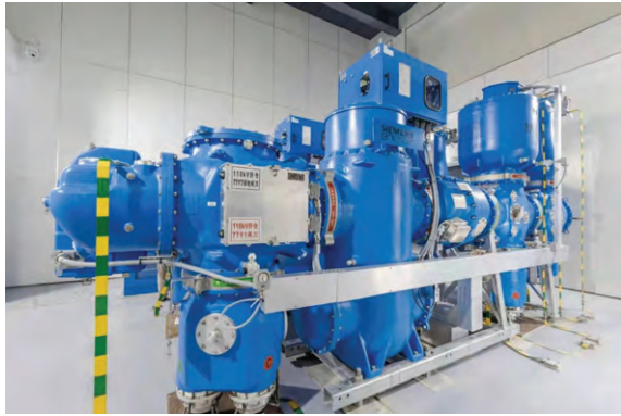
图6 无锡清舒变电站运行的 145 kV Blue GIS
