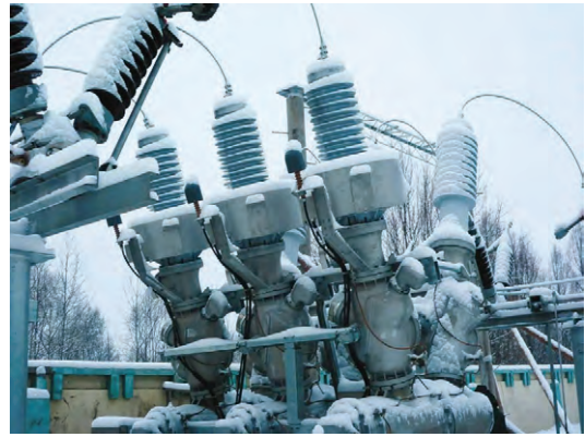
图7 沈阳华德海泰 72.5 kV H-GIS
