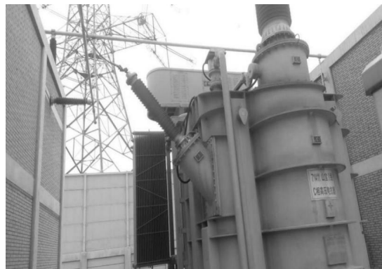
图 C.1 750 kV 电抗器 C 相设备照片
